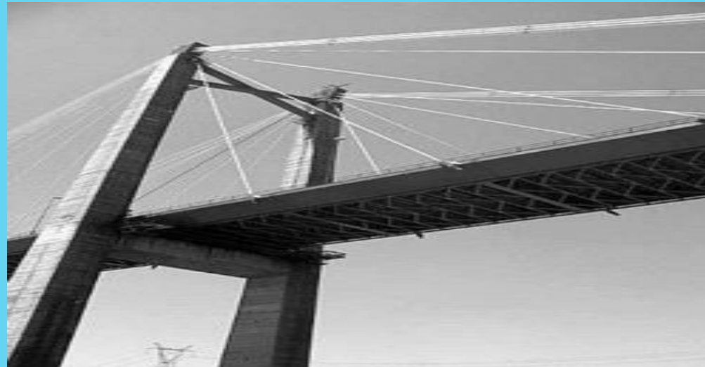
ROTURA DE UN OBENQUE
